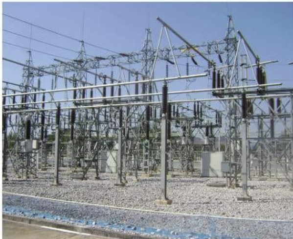
สถานไฟฟ้า
