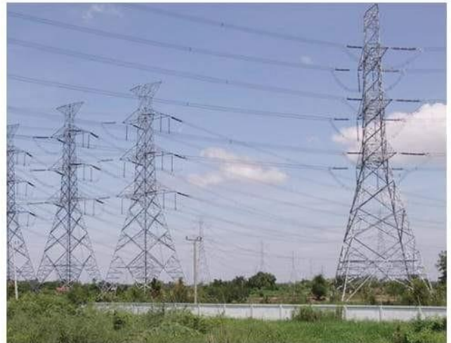
เสาไฟฟ้า
