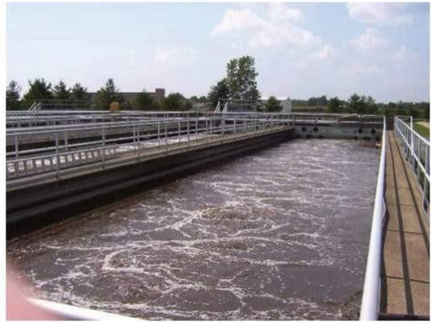
บ่อบำบัดน้ำเสีย
